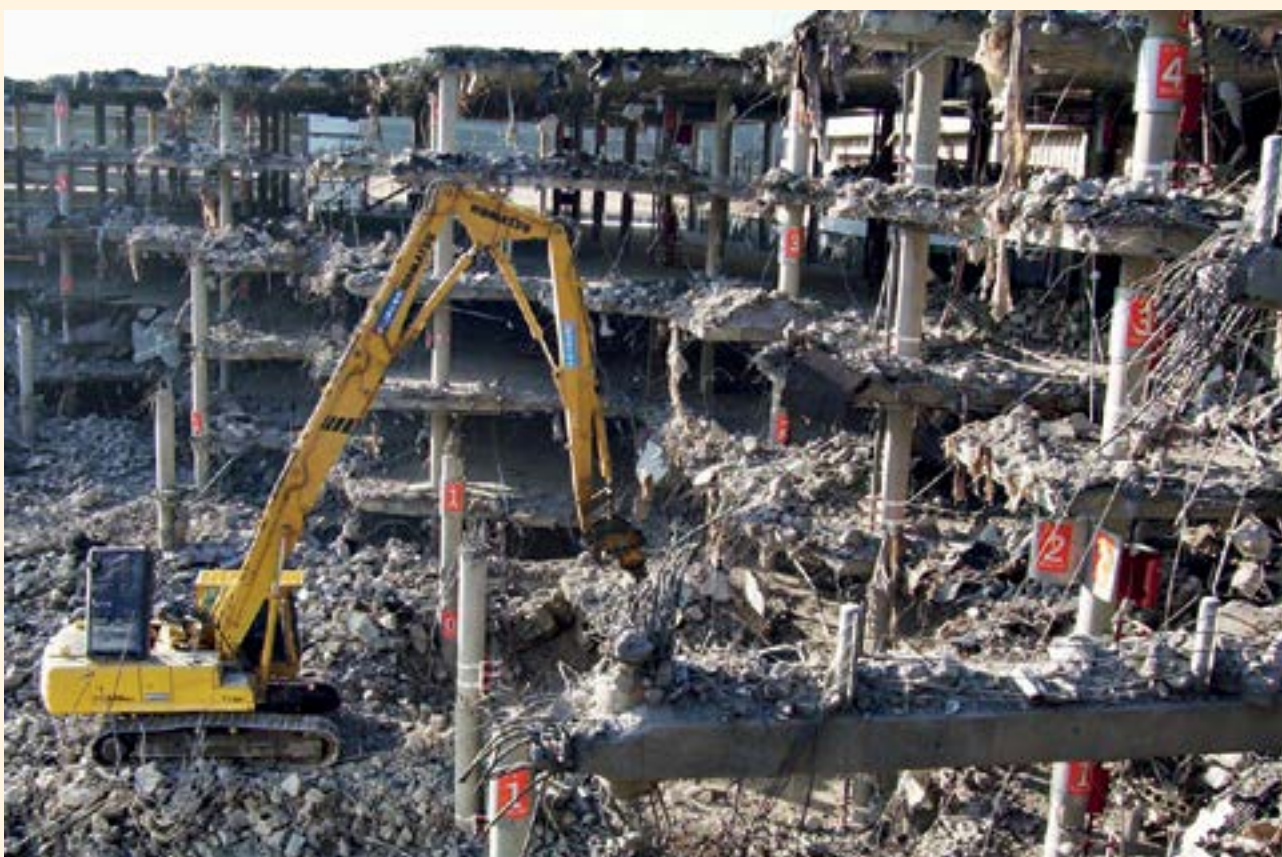
Imagen de desescombros tras el atentado perpetrado en la Terminal 4 del aeropuerto "Adolfo Suárez Madrid-Barajas" (2006)
